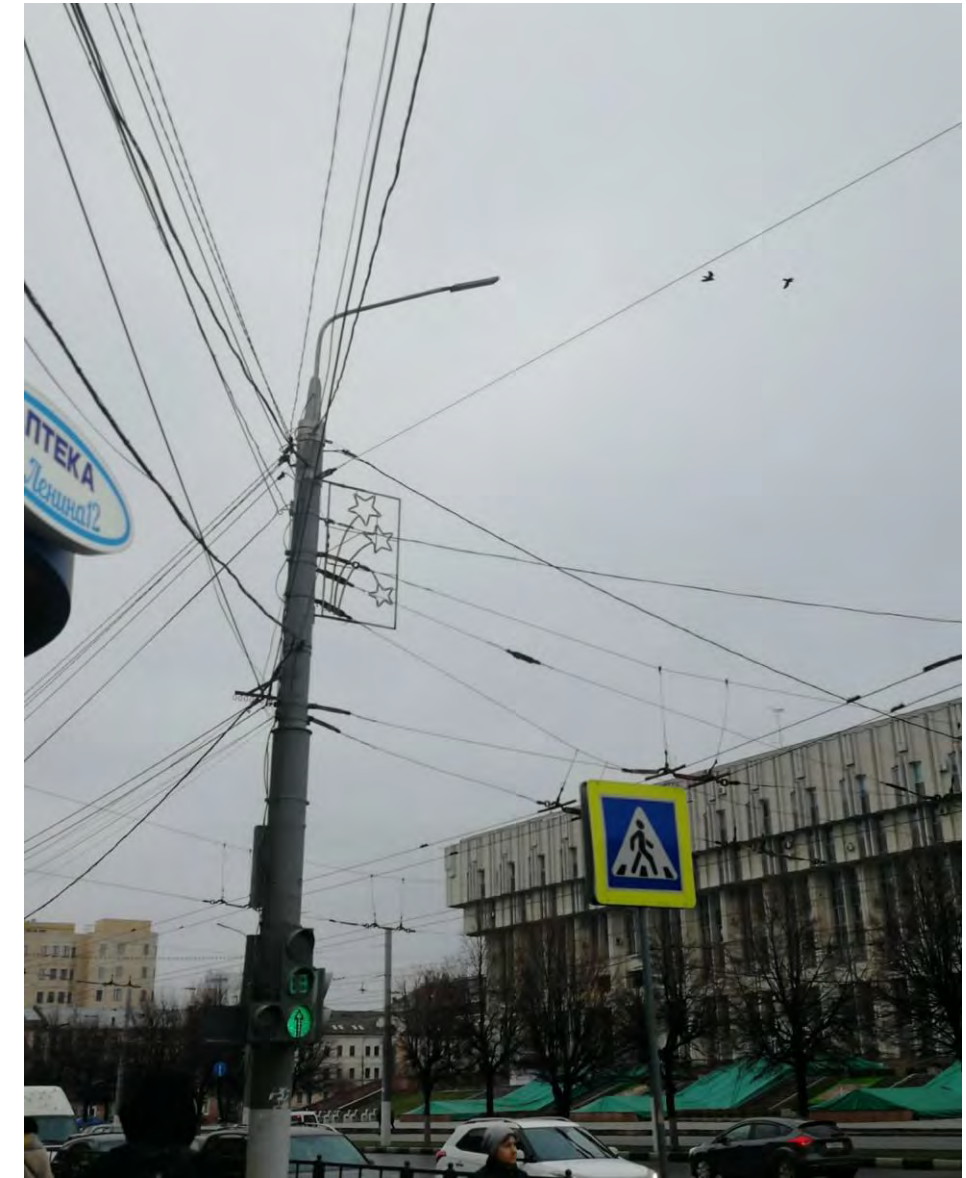
ПЛОХО. Недопустимая воздушная прокладка проводов
