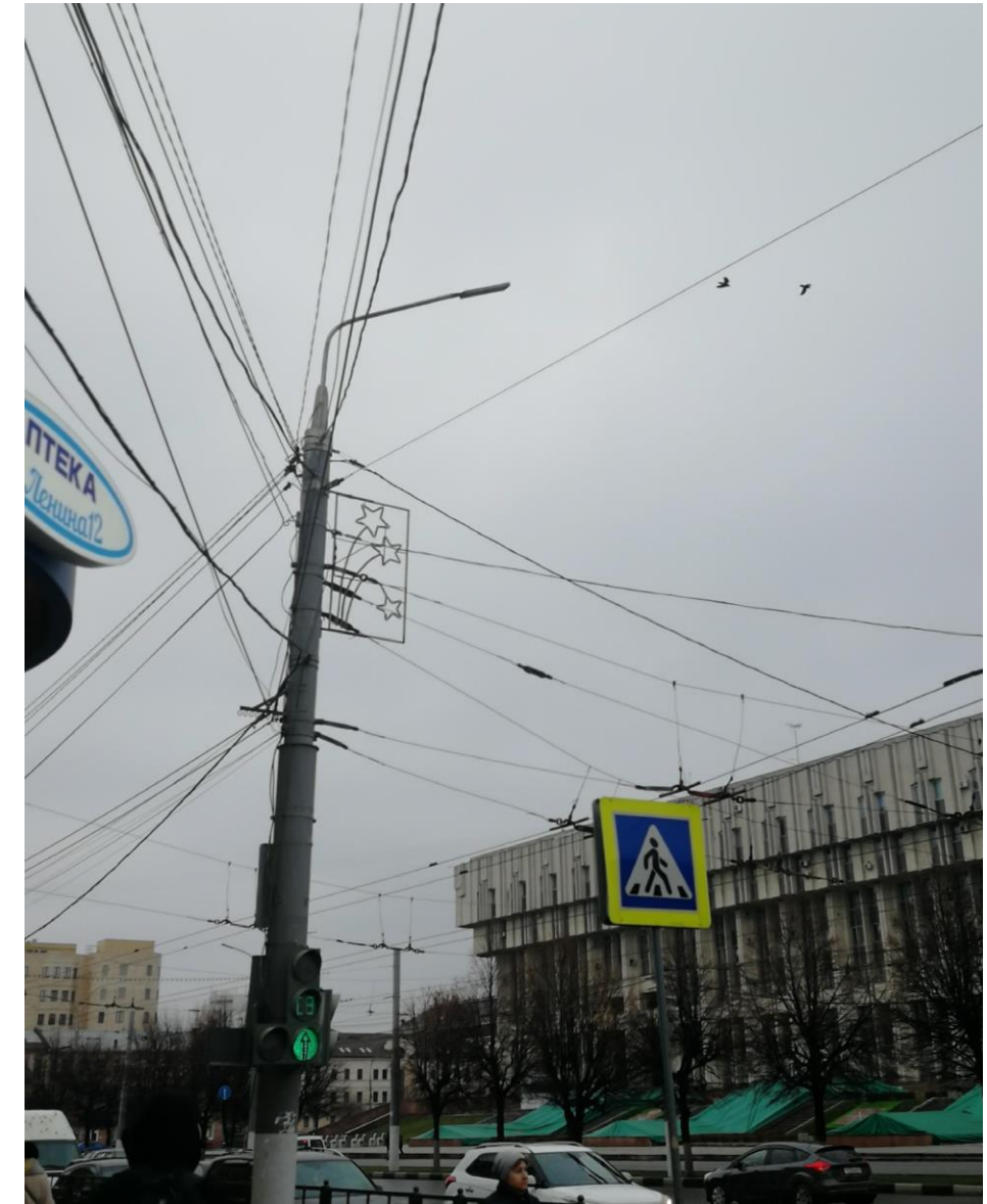
ПЛОХО. Недопустимая воздушная прокладка проводов
